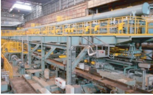
写真4 オンライン熱処理設備の外観
